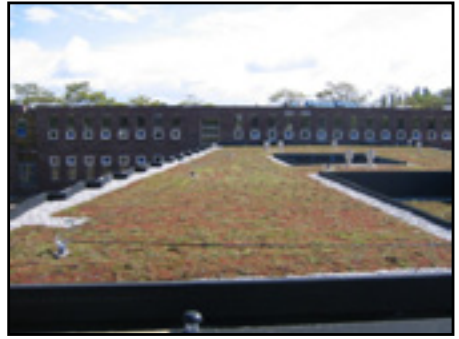
Tiel: Geballast systeem met groendak
